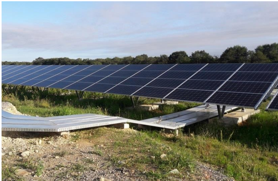
Figure 31: Exemple de chemin de câbles
