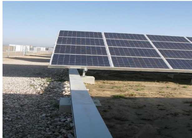
Figure 26 : Exemple d'un chemin de câbles
