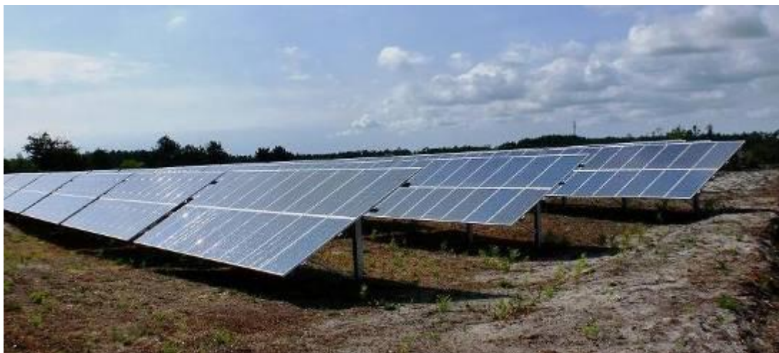
Figure 16 : Exemple de centrale photovoltaïque équipée de panneaux fixes – technologie cristalline (couche épaisse)
