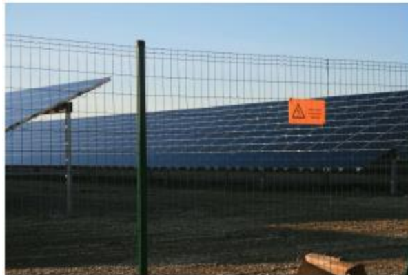
Figure 35 : Clôture grillagée autour d'une centrale solaire photovoltaïque
