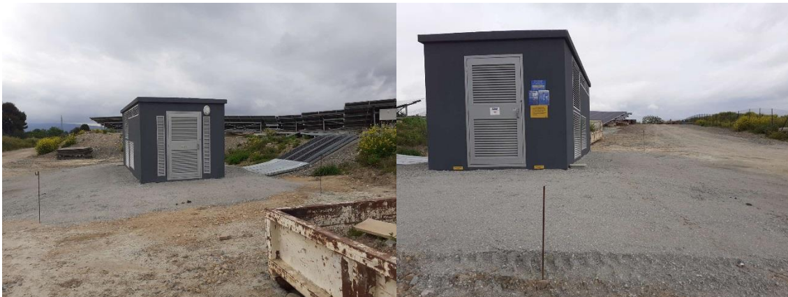
Figure 23 : Exemple de poste de transformation
